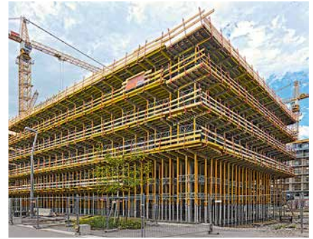
Решения PERI с применением MULTIPROP и MULTIFLEX, кроме формирования балконов по контуру служили одновременно в качестве рабочей площадки.
